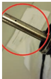
Corrosión en el conector de alimentación
