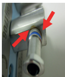
Corrosión en el adaptador
