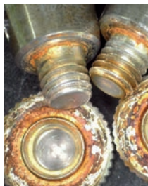
Corrosión en el enchufe de alimentación
